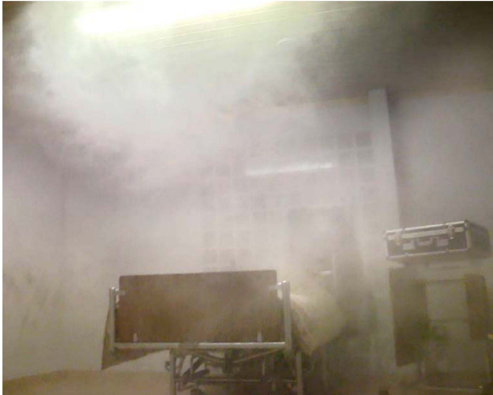
Sprinklern pressar ut vattnet under högt tryck, och det sprids som en dimma i rummet samtidigt som temperaturen sjunker.
